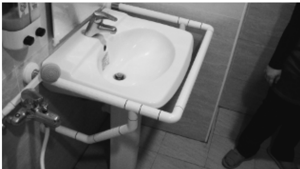
図 30. 共有シャワー 浴槽に入る習慣がないため、共有トイレ内でシャワーを浴びる。スペースも狭い。排水設備も不十分。
